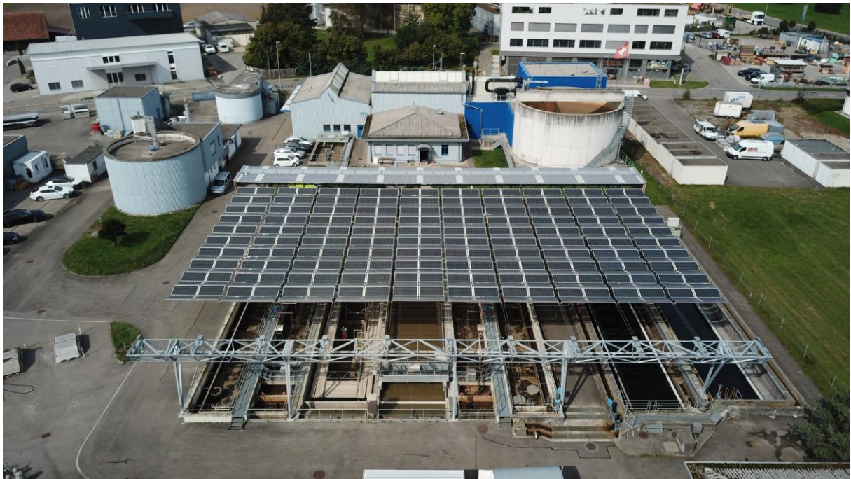
Fotovoltaikanlage auf Klärbecken ARA Schanz
